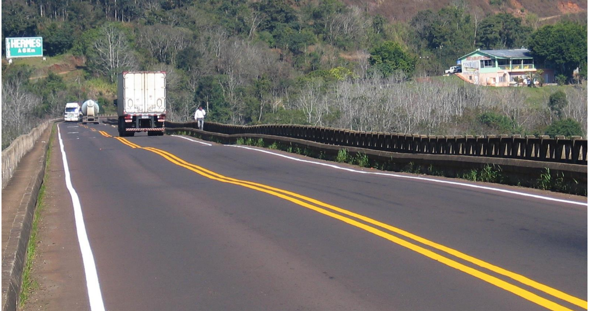
Figura 8 - Deformação no tabuleiro da ponte sobre o Rio Uruguai (BR-158/RS)
