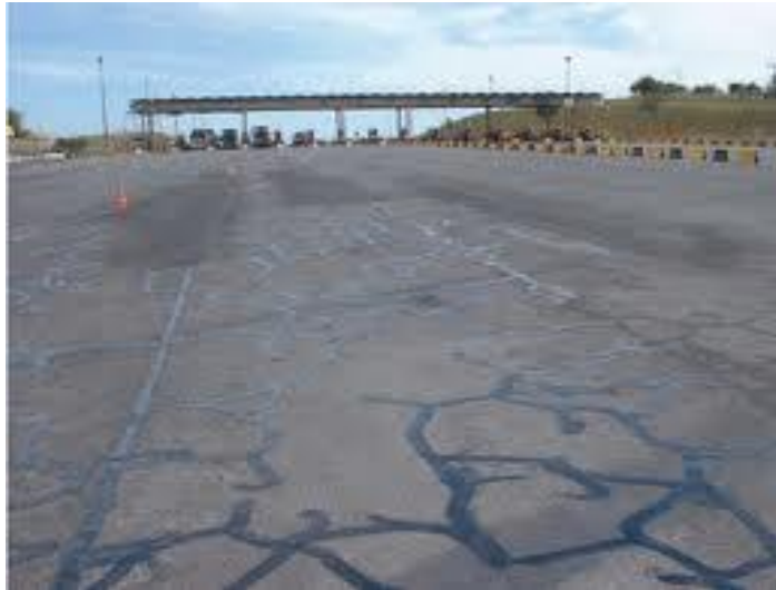
Figura 2.3 - Fissuras seladas em revestimento asfáltico de uma rodovia.
