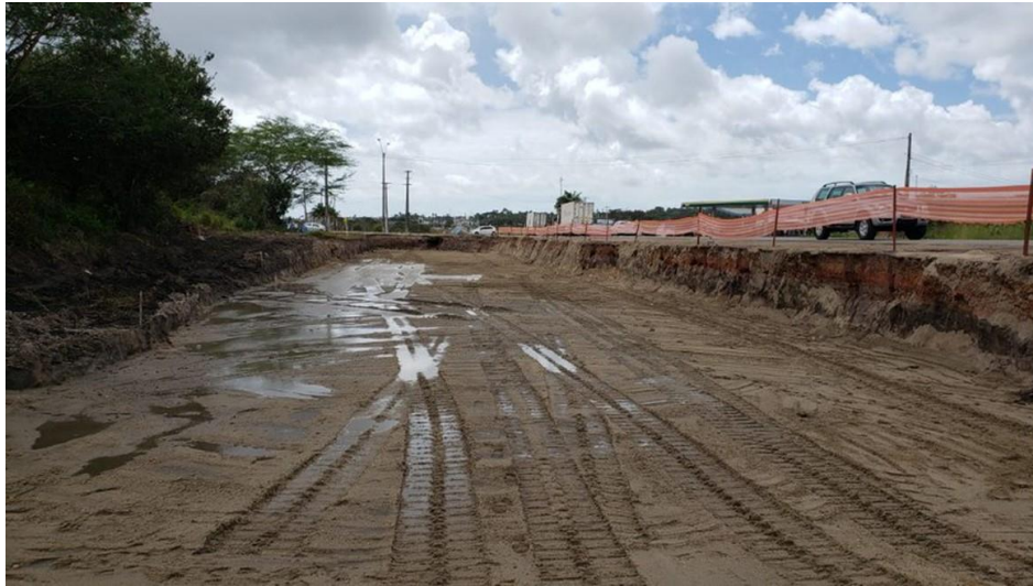
Figura 3.16 – Colchão drenante de areia executado junto de trecho com surgência de água no subleito, nas obras de duplicação da BR-304/RN. (Fonte: Próprio autor).
