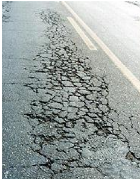
Figura 2.4 - Patologia do tipo couro de jacaré em revestimento asfáltico de uma rodovia.
