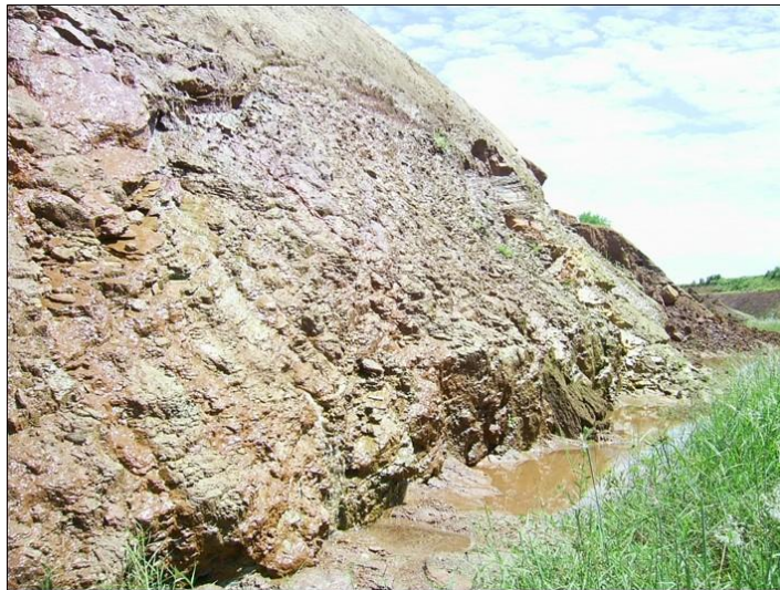
Figura 3.19 – Aflorescimento de água nas faces de talude de corte em trecho da Ferrovia Norte-Sul, junto de Mara Rosa/GO. (Fonte: próprio autor).
