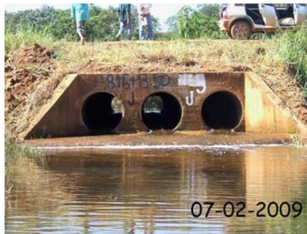
Figura 2.6 B – BTTC instalado em rodovia (Fonte: próprio autor).
