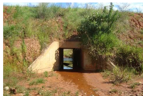
Figura 2.10 B – BSCC instalado em rodovia. (Fonte: próprio autor).
