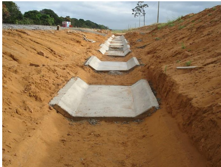
Figura 3.5 – Valeta trapezoidal de concreto executada in loco e em segmentos alternados. (Fonte: próprio autor).
