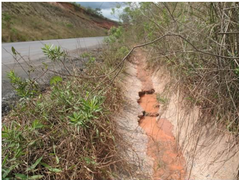
Figura 2.8 – Sarjeta danificada em trecho da BR-354/MG próximo à cidade de Bambuí/MG. (Fonte: próprio autor).
