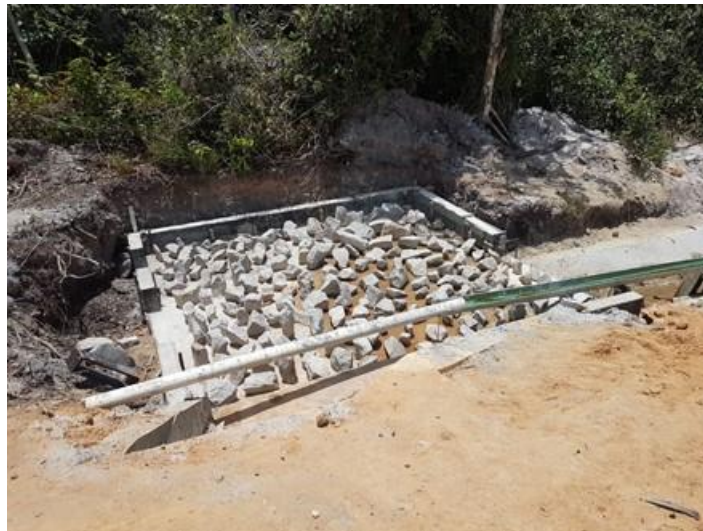
Figura 3.20 – Dissipador de energia em construção nas obras de duplicação da BR-304/RN. (Fonte: próprio autor).
