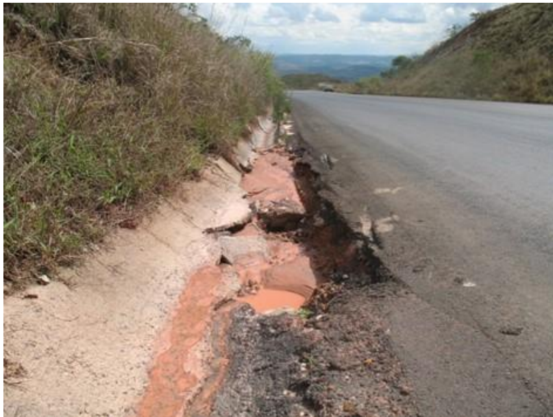
Figura 2.7 – Sarjeta danificada em trecho da BR-354/MG próximo à cidade de Bambuí/MG. (Fonte: próprio autor).
