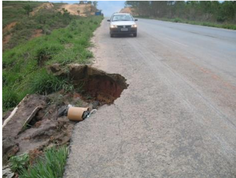
Figura 3.18 – Colapso do conjunto entrada d'água e descida d'água na BR-354/MG (Fonte: próprio autor).
