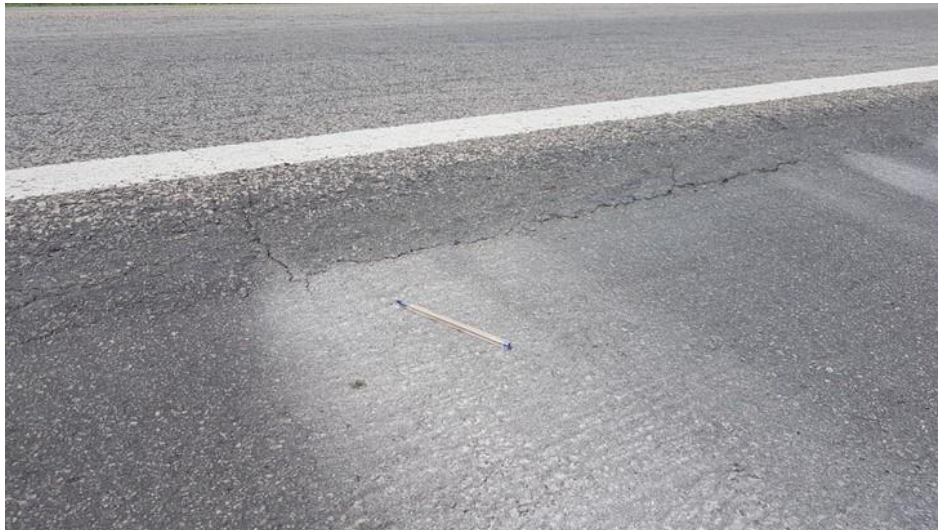
Figura 2.2 – Trecho da BR-304/RN onde pode ser notada a presença de manchas causadas pela lixiviação de partículas sólidas do interior do pavimento. (Fonte: próprio autor).
