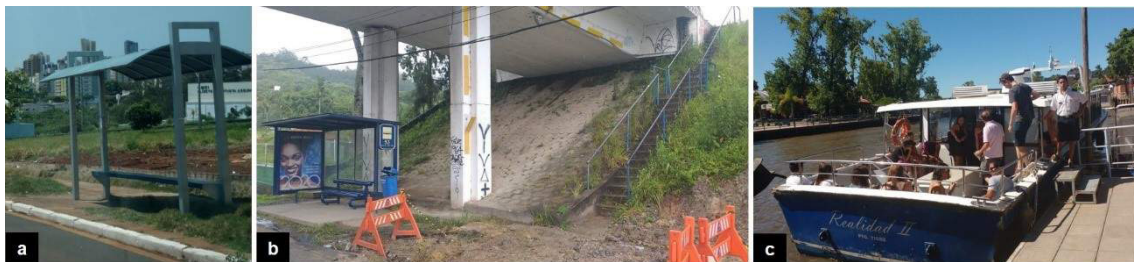
Fig. 1: a) Ponto de ônibus sem informação e com calçamento precário em Maringá (PR). b) Ponto de ônibus abaixo do viaduto em Florianópolis sem acesso universal, sem calçamento e sem informações. (c) Falta de acesso à embarcação, Tigre (ARG).
